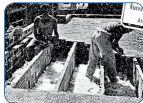
Amianto suelto en cámara de cubierta 1
