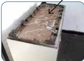
Amianto suelto en el interior de un radiador
