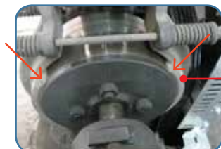
Zapatas de freno de motor de ascensor.
