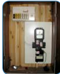
Panel aislante detrás del contador
