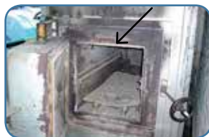
Cordón de amianto sellando la puerta 2
