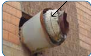
Calorifugado en conducto de evacuación de humos industriales
