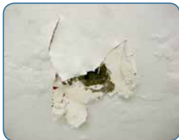
Pintura con amianto
