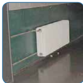
En pavimento y zócalo 1
